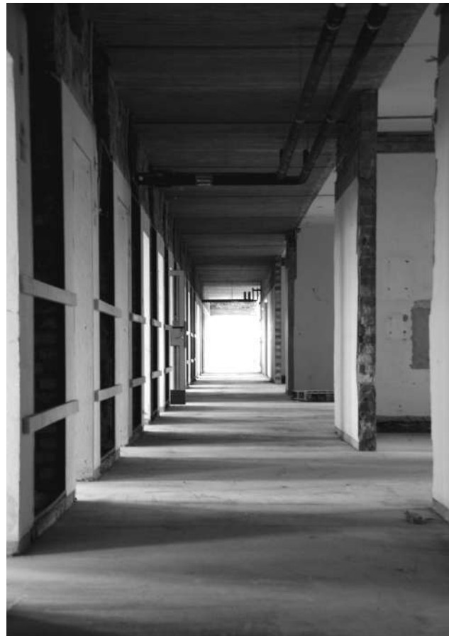
Korridor med kanalbärande hjärtmur av tegel till vänster. Bjälklag av platsgjuten betong.
