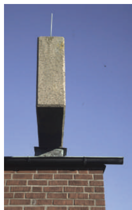
Exponerad betongbalk på lågdelen av Kemiskt Centrum. Hängränna av koppar.
