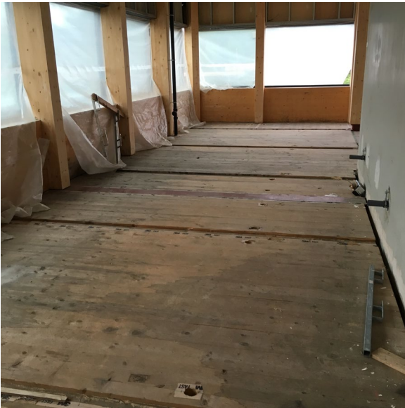
28. Fuktpåverkat bjälklag plan 5, etapp B
