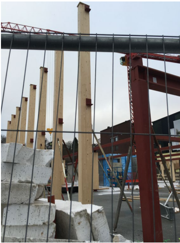
15. Pelare i fasad skyddas i ovankant.
